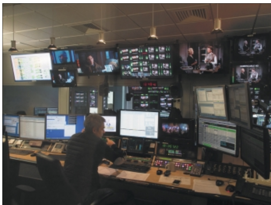
Blick in die Regiezentrale.
